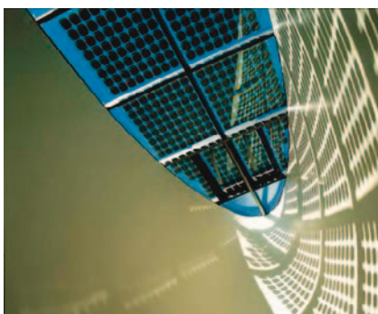
Figur 6. Anvendelse af solceller i ovale ovenlys på indskolingshuset Lærkelængen i Albertslund.
