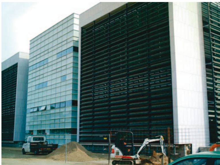
Figur 59. Foto af sydfacaden på Syddansk Universitet, hvor solafskærmningen og reguleringssystemet var installeret i 'plusenergikontoret'.
